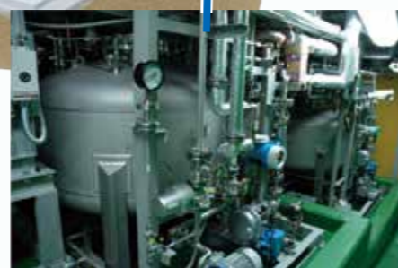
キセノン取扱い設備 [4]
